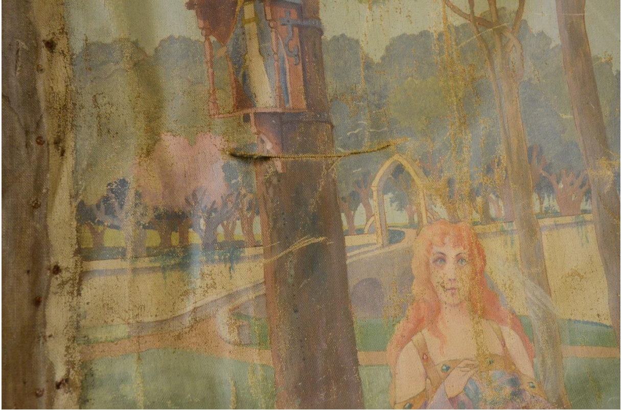
Détail avec dégradations de surface
