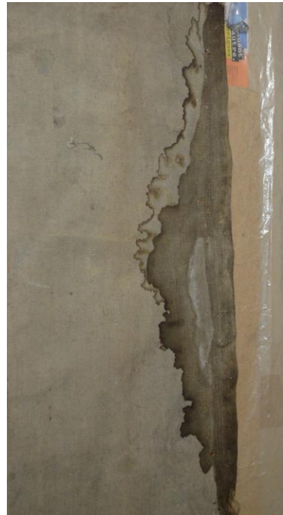
Traces de dégâts des eaux
